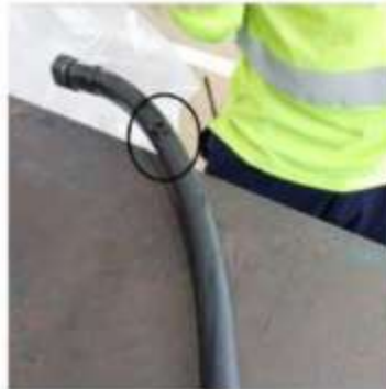
Imagen 3. Evidencia de manguera con daño.
