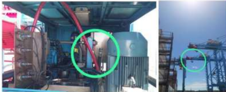
Imagen 1. Evidencia del equipo que presenta daño.
