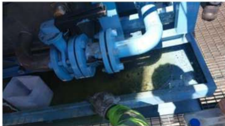
Imagen 2. Evidencia de la contención del producto en la bandeja de la grúa.
